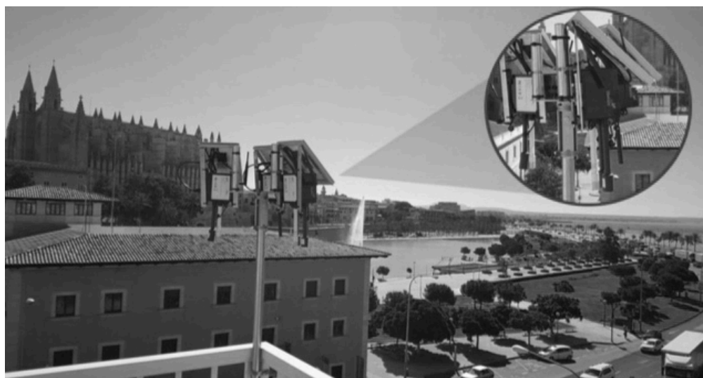
Figura 2. Sensor Ambiental IoT instalado en Sede Autoridad Portuaria de Palma
