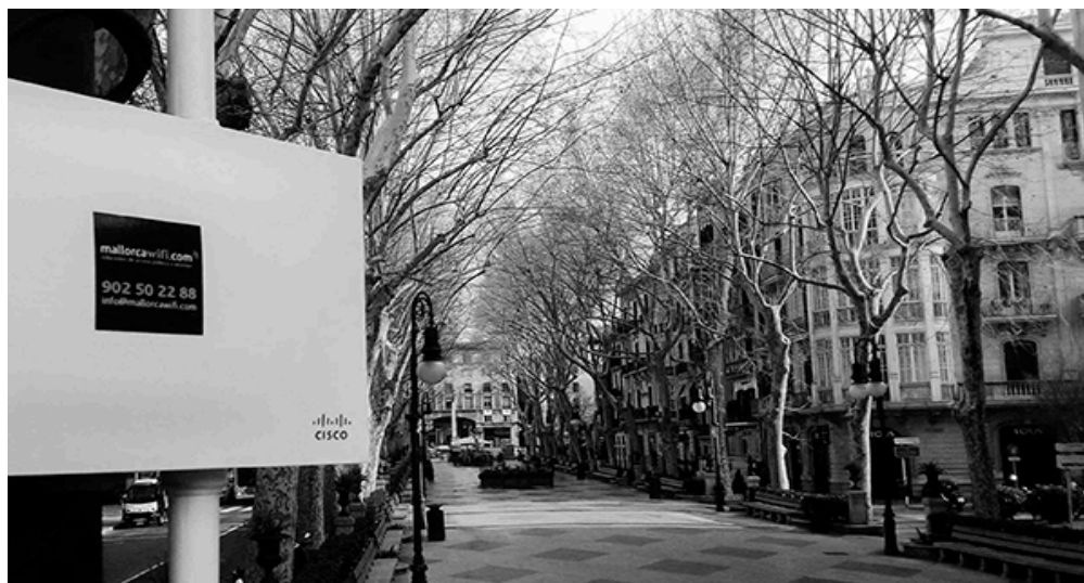
Figura 1. Punto Acceso Wi-Fi instalado en Paseo del Borne de Palma
